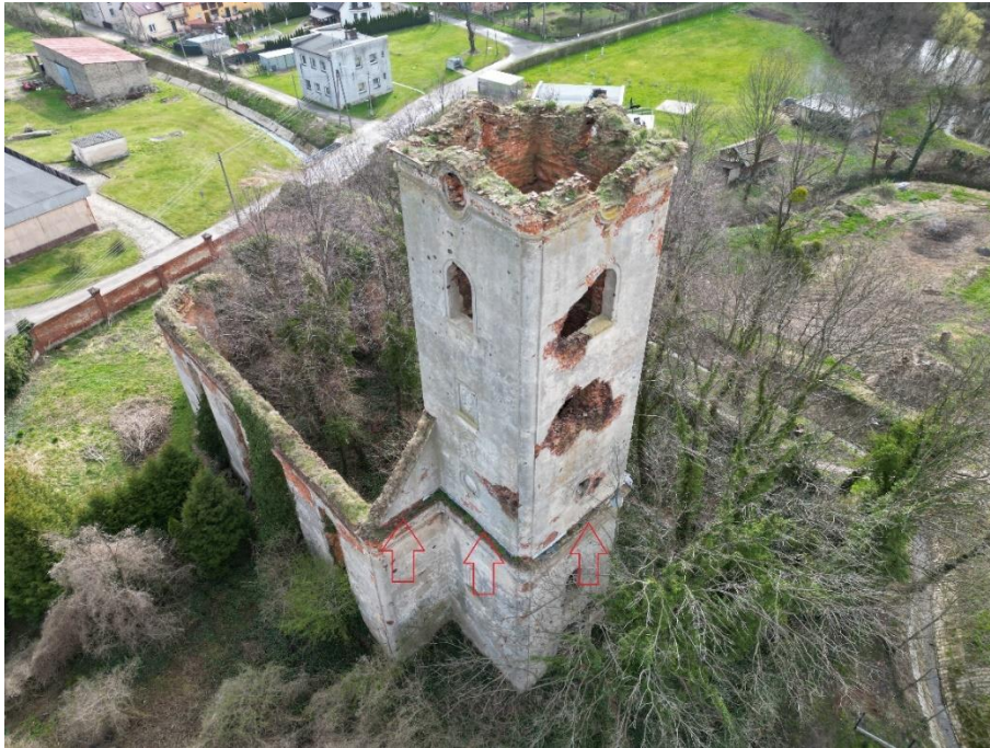
Zdj. 9. Gzyms, z którego należy usunąć roślinność i dachówki.
