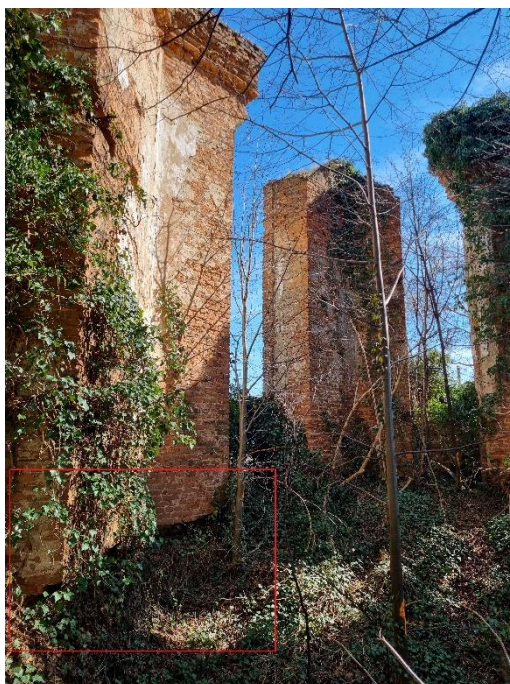
Zdj. 6. Fragment uszkodzonej ściany, którą należy podmurować.
