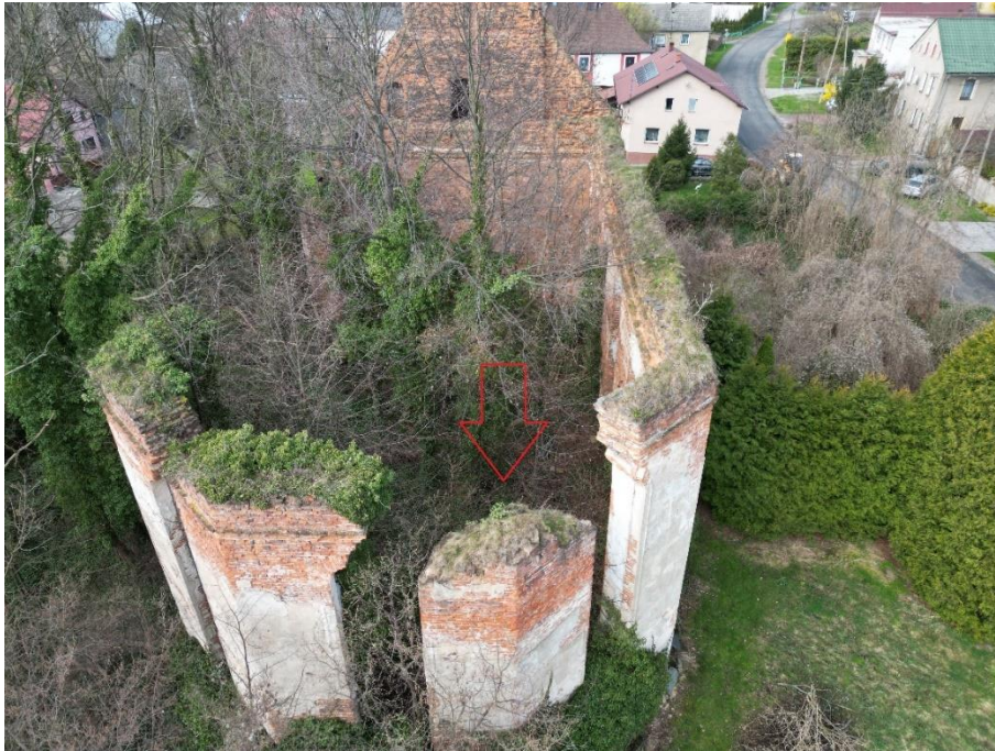
Zdj. 13. Otwory okienne, nad którymi należy odtworzyć nadproża łukowe.
