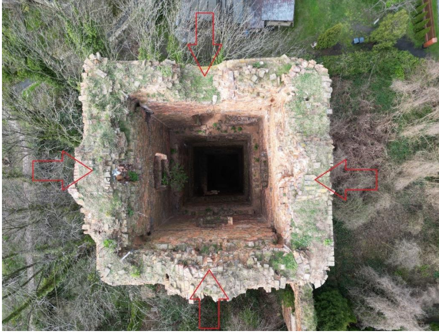
Zdj. 7. Korona muru wieży, z której należy usunąć roślinność i cegły.
