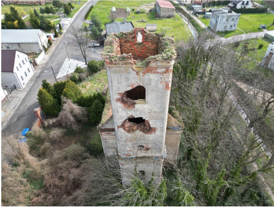
Zdj. 15. Otwór okienny, nad którym należy odtworzyć naproże łukowe.
