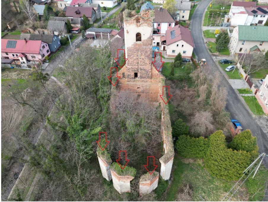
Zdj. 11. Korony muru ścian, z których należy usunąć roślinność i cegły.
